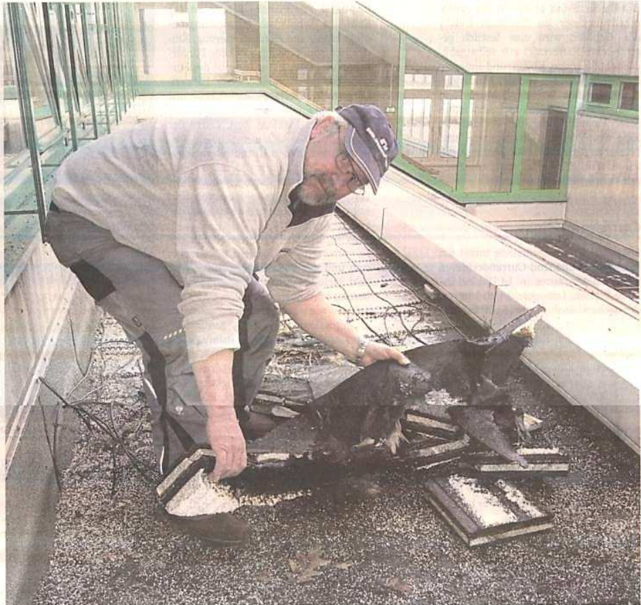
Dieter Haarhaus entdeckte den Brand: Eine defekte Heizanlage hatte Dachmaterial entzündet.
